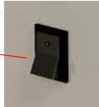
Interruttore generale Main switch
